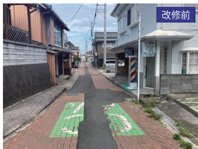
▲配管工事の復旧痕が目立つ舗装
